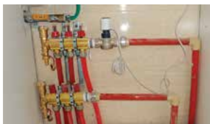
Danfoss-fordelerrør med RA-G-ventil og TWA-A-aktuator. Denne kombination blev installeret i de mindre lejligheder for at give central temperaturstyring via en CWD-termostat i det primære opholdsrum. Der blev installeret individuelle rumstyringer i de større lejligheder.
