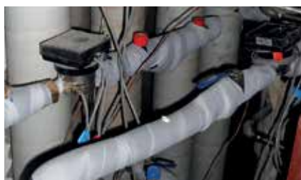
Der blev installeret Danfoss ASV-indreguleringsventiler og energimålere i teknikrummet for hver enkelt gruppe på fire lejligheder.
