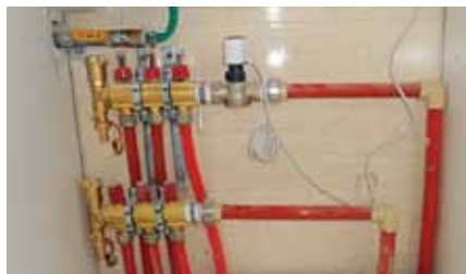
Rozdělovač/sběrač Danfoss s ventilem RA-G a pohonem TWA-A. Tato kombinace byla instalována v menších bytech, aby byla zajištěna centrální regulace teploty prostřednictvím termostatu CWD v hlavní obytné místnosti. Samostatné regulační prvky v místnostech byly instalovány ve větších bytech.
