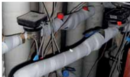
Vyvažovací ventily Danfoss ASV a elektroměry byly instalovány v technické místnosti pro každou skupinu čtyř bytů.
