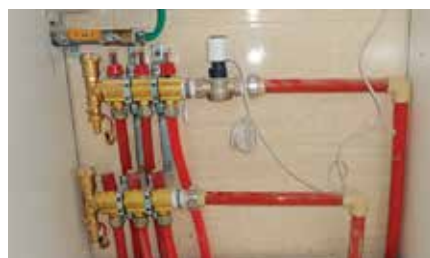
Danfoss kolektorius su RA-G vožtuvu ir TWA-A pavara. Šie abu prietaisai buvo sumontuoti mažesniuose butuose, siekiant centralizuotai CWD termostatu, sumontuotu svetainėje, reguliuoti temperatūrą. Didesniuose butuose buvo sumontuoti individualūs kambario valdikliai.
